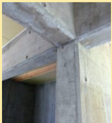
⑤ がっしりした鉄筋コンクリートの基礎。あなたの目と体で確認して下さい。
